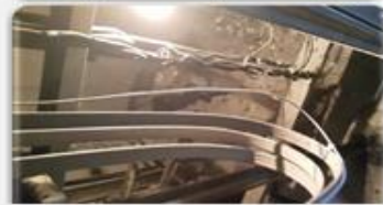
승강기 및 CCTV Cable
