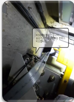
승강기 및 CCTV Cable
